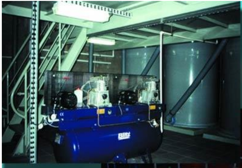
Рис. 4. Канализационная насосная станция со встроенным блоком очистки загрязненных дождевых, талых вод и вод от мойки транспорта автоцентра «ВОЛЬВО», г. Киев
